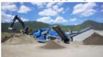
Østremningsanlegg Mellomlagring, Østanger
