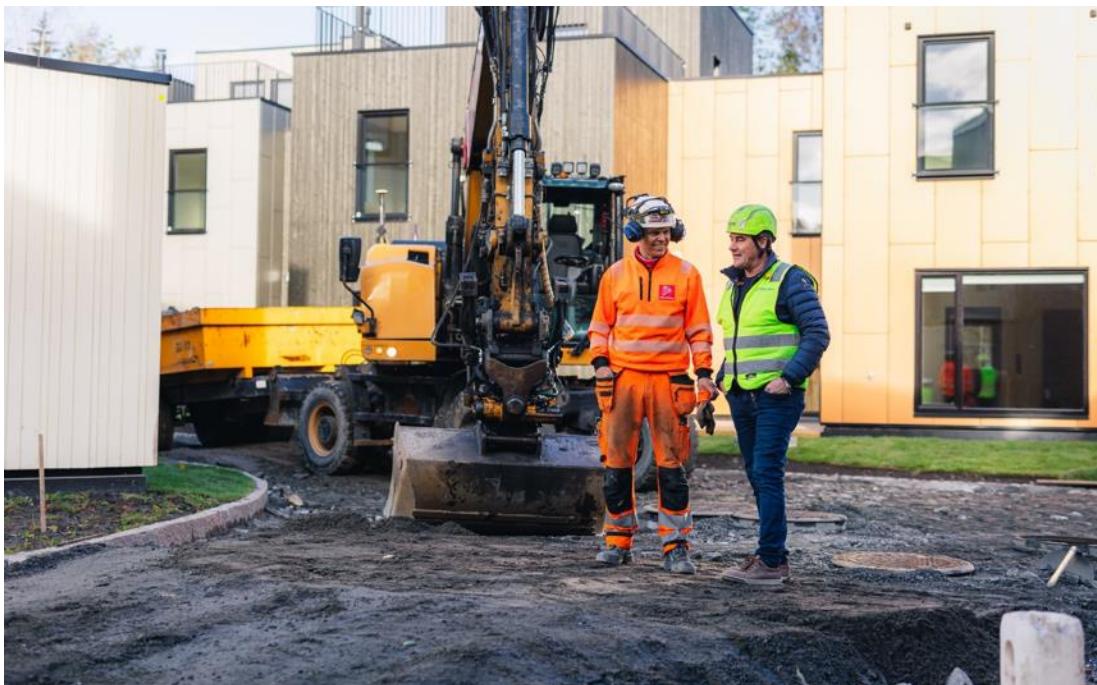
Maskiner og menn i sving på Dyst med utlegging av masser av knust stein fra byggetomta
