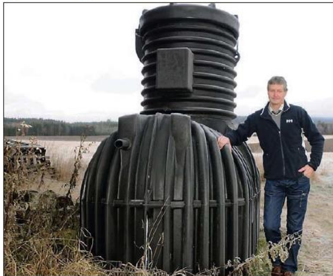
I Aurskog-Høland er det for tiden mange slike minirensesanlegg. Innen utgangen av 2015 skal alle husstander som ikke er tilknyttet kommunalt avløp ha installert slike godkjente anlegg, opplyser prosjektleder Trond Syversen. Foto: Øivind Eriksen
