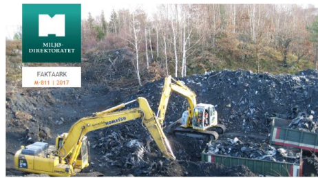
Opprydding i forurenset grunn ved bygge- og gravearbeid er tiltakshavers ansvar. Foto: Kine Martinen, Miljødirektoratet
