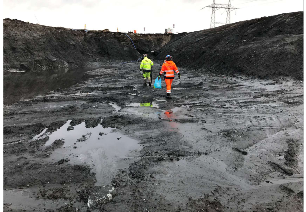
Ferdig traubunn – klar til å bygge opp veikroppen
