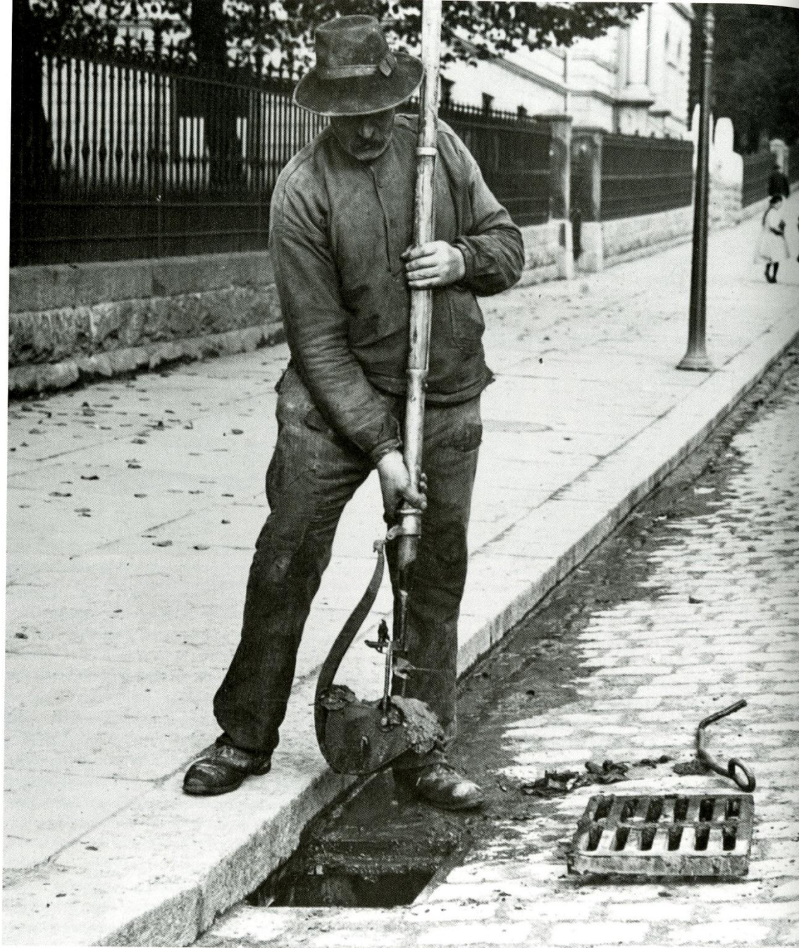
Avløpssystemet i Bergen var basert på den kombinerte løsningen: Det fraktet både kloakk og overflatevann. For å unngå at for mye sand, grus, rusk og rask havner i avløpsrørene er det nødvendig å forsyne gateslukene med oppsamlingskummer, såkalte "sandfangkummer". Disse må jevnlig tømmes for å unngå tette sluk og flom i gatene. På bildet ser vi en av vann- og kloakkvesenets arbeidere i gang med å renske opp et gatesluk.
