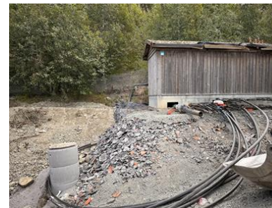
Forbedring av deponi oppsamlingsystem
