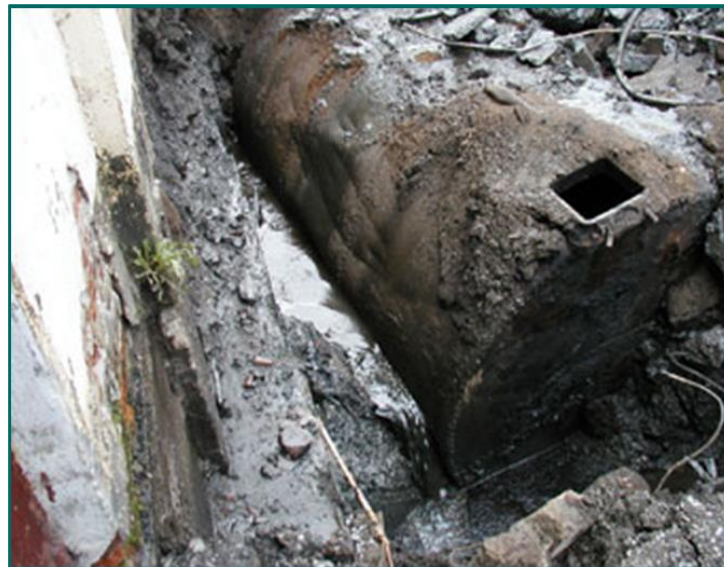
Nedgravd oljetank. Foto: Vann- og avløpsetaten, Oslo kommune.
