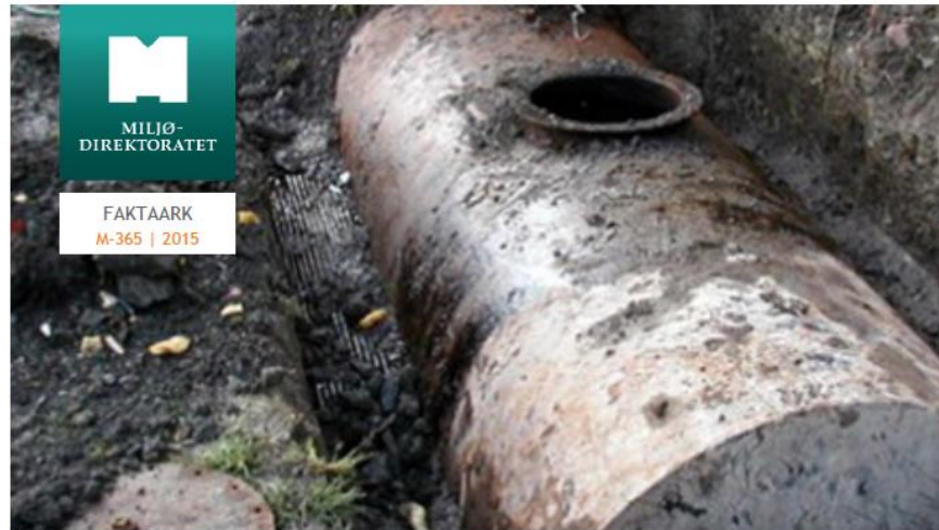
Lekkasjer fra nedgravde oljetanker er en hyppig kilde til forurenset grunn. Bruk av oljesaneringskjemikalier til oppryddning av forurenset grunn krever søknad om tillatelse. Foto: Vann- og avløpsetaten, Oslo kommune.
